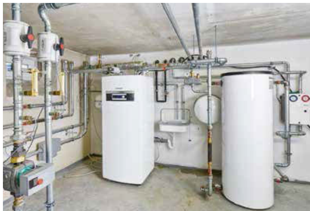
Moderne Heizanlage des Plusenergiehauses in Bottrop
